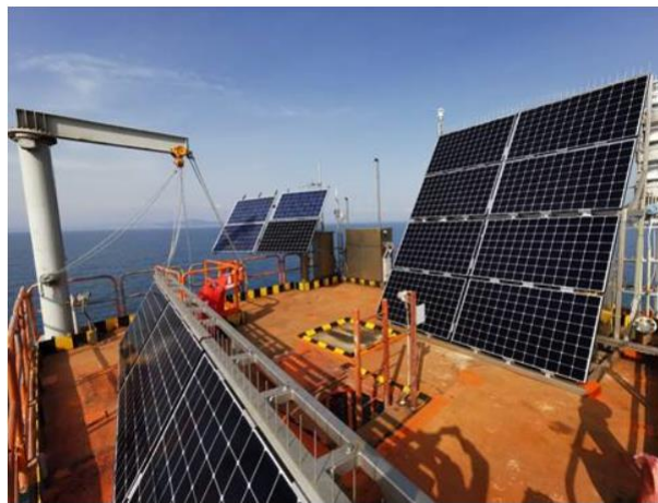
Fig. 2 – Pannelli solari ad alta efficienza installati sulla piattaforma Viviana a Pescara nell’ambito del progetto PLaCE ( https://bluegrowth-place.eu/?p=1401 )
