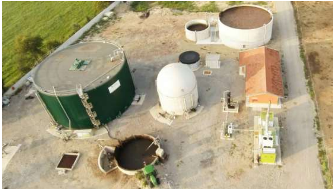
Impianto di abbattimento dei nitrati
